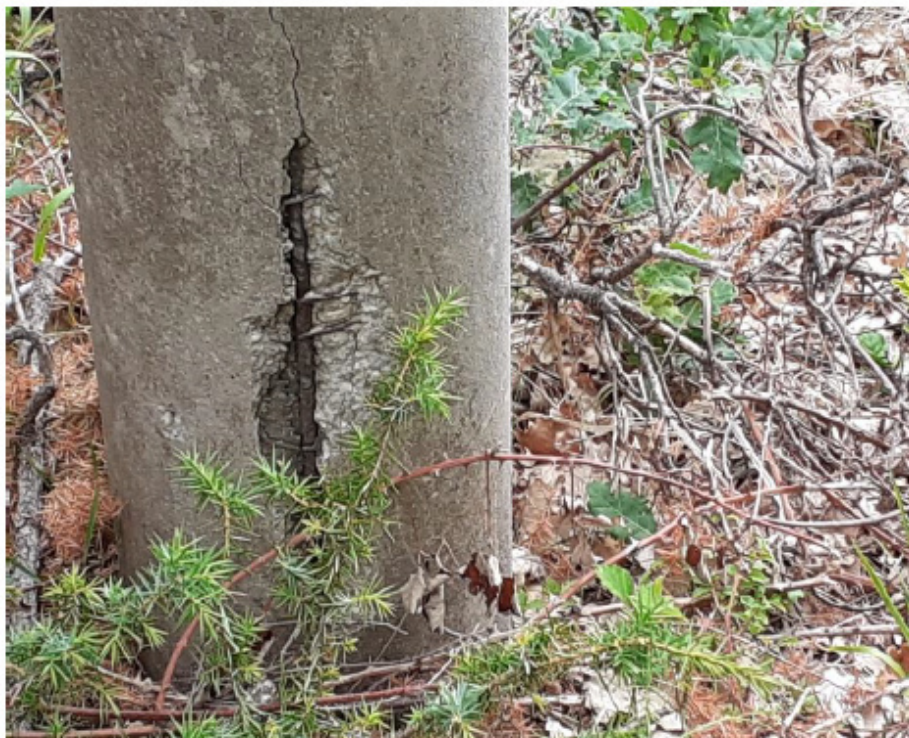
Alcuni esempi di danni ai pali di cemento della Media Tensione
