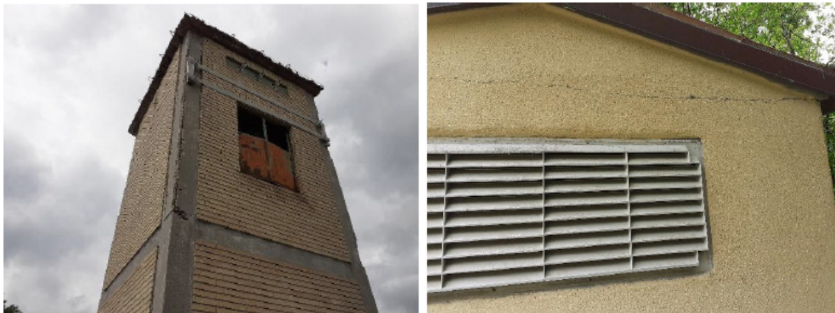
Alcuni esempi di danni alle cabine
