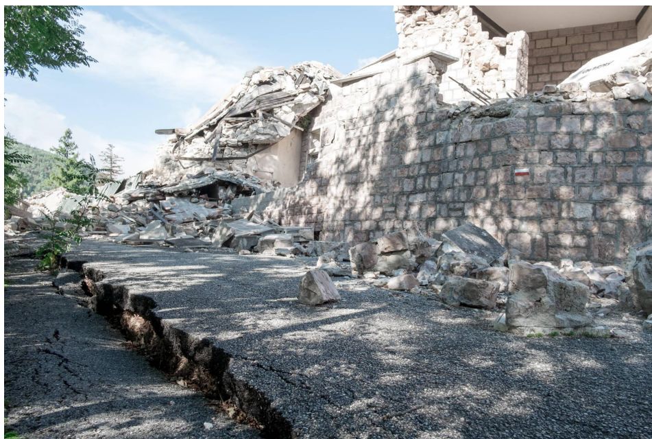
Muro di cinta lato meridionale con evidenza del dissesto della strada che lo costeggia
