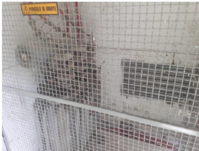
Trasformatore in cabina
